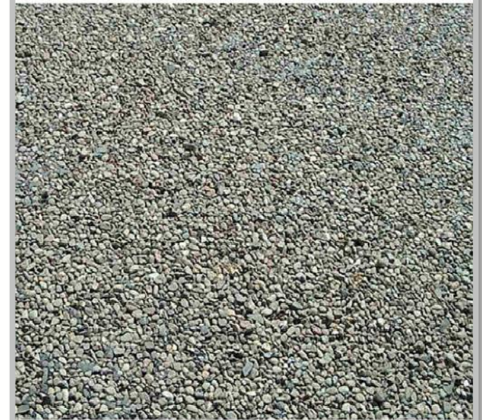
Asphalt mit Splittabstreung
